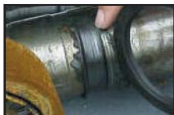
Повреждение вала от манжетного уплотнения
